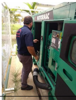
Foto 05 – Manutenção preventiva do gerador
