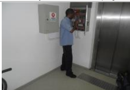
Foto 3 – Manutenção preventiva do elevador
