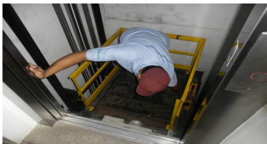
Foto 05 – Manutenção preventiva mensal dos elevadores
