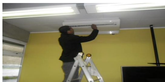
Foto 04 – Manutenção preventiva mensal de ar condicionado
