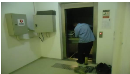
Foto 03 – Manutenção preventiva do elevador
