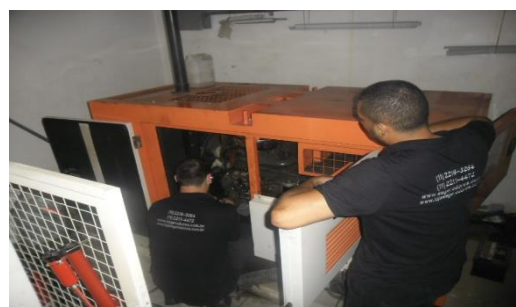
Foto 02 – Manutenção preventiva mensal do gerador
