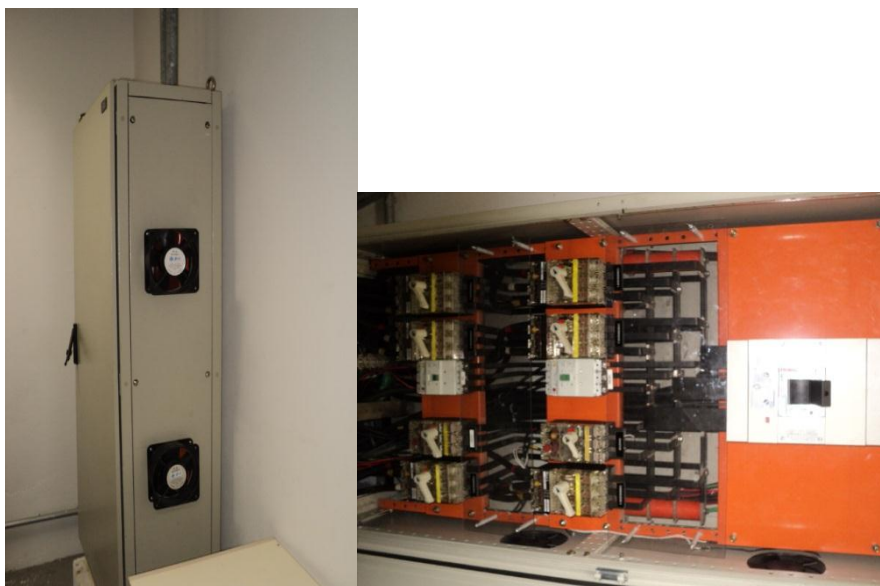
Fotos do Quadro de Força do Ar Condicionado com o sistema de exaustão instalado e todos os terminais dos barramentos apertados e pontas dos cabos de energia soldados
